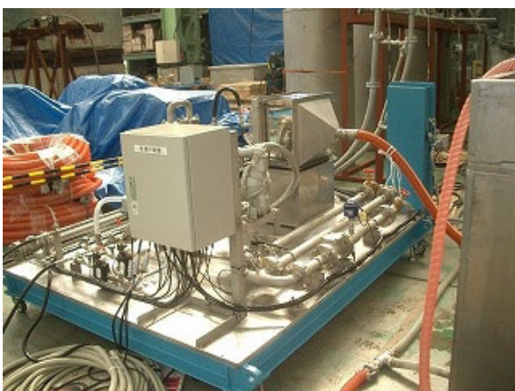
写真2 吸着塔水抜き・乾燥装置-屋内ユニット
