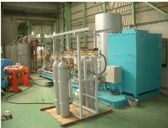
写真1 吸着塔水抜き・乾燥装置-屋外ユニット
